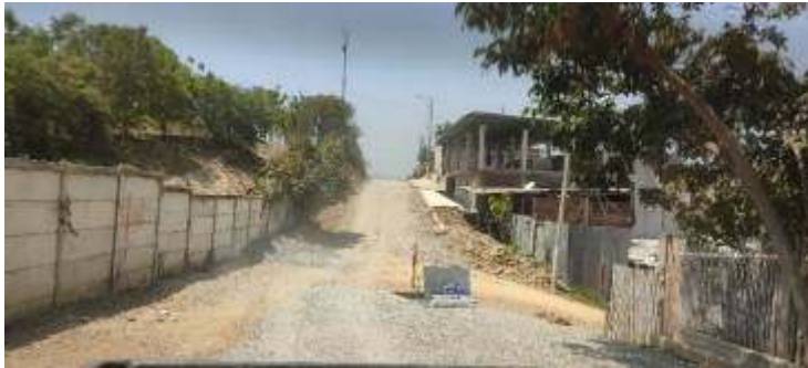
Fotografía 72 Parte lateral del Parque las Iguanas por dónde va el acueducto
