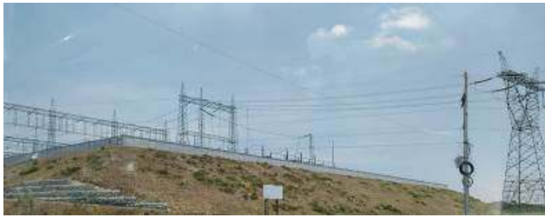
Fotografía 50. Subestación Eléctrica existente en el tramo del 5to acueducto
