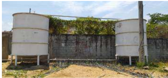
Fotografía 42 Contenedores de agua desde la PTAP La Toma y Flautas de distribución para el Barrio Los Pinos
