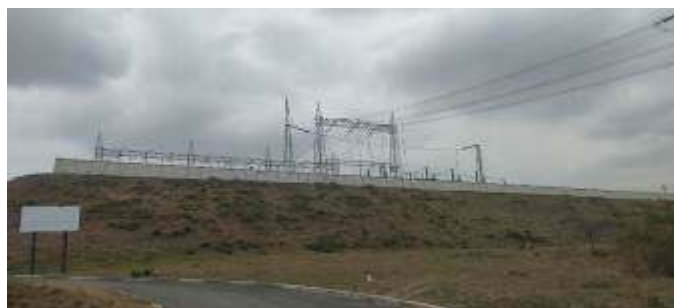
Fotografía 37 Estación eléctrica en la zona del proyecto
